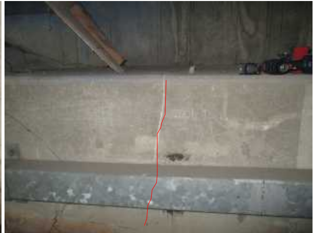
A2 교대 균열(0.3mm미만)
