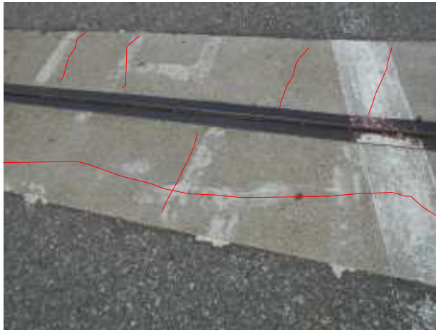
A1 후타재 균열
