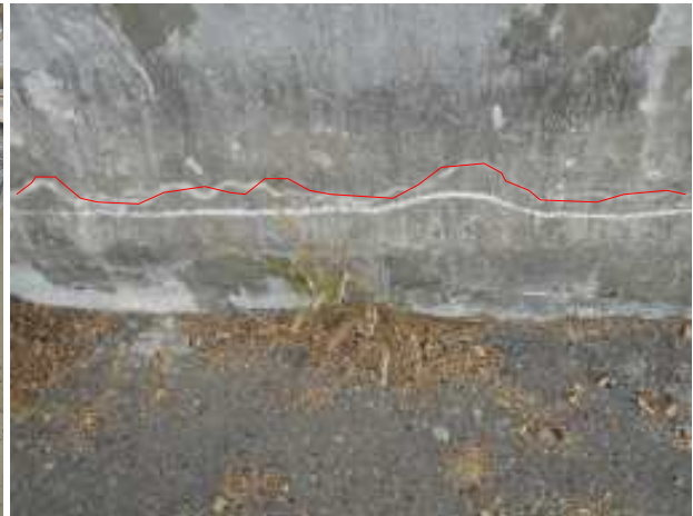
S2 방호벽 균열(0.3mm미만)
