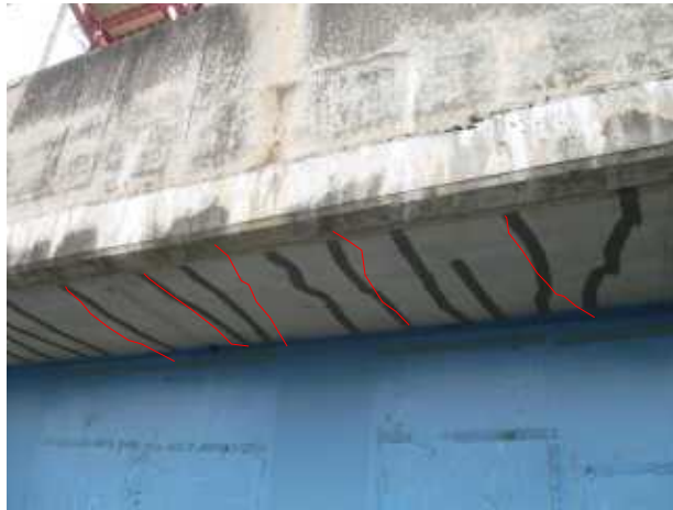
S2 바닥판 하면 균열(0.3mm이상)
