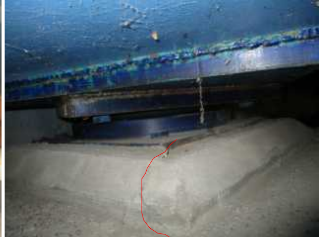
A2 Sh1 받침Con'C 균열
