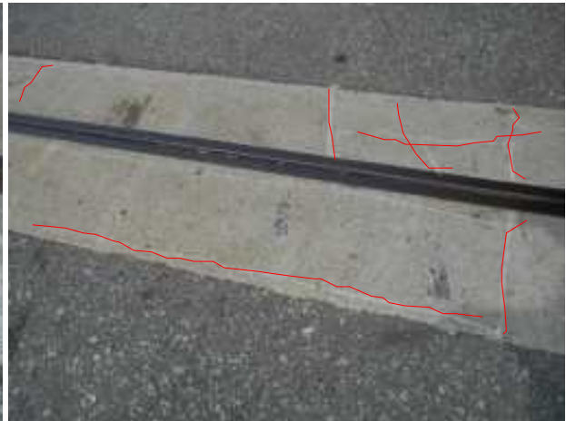
A2 후타재 균열
