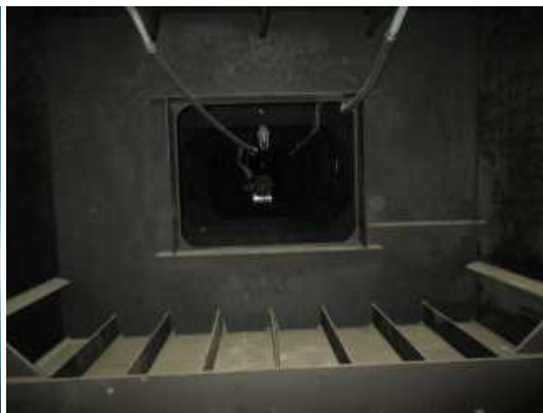
(S4 G1) S.T BOX 내부 상태양호
