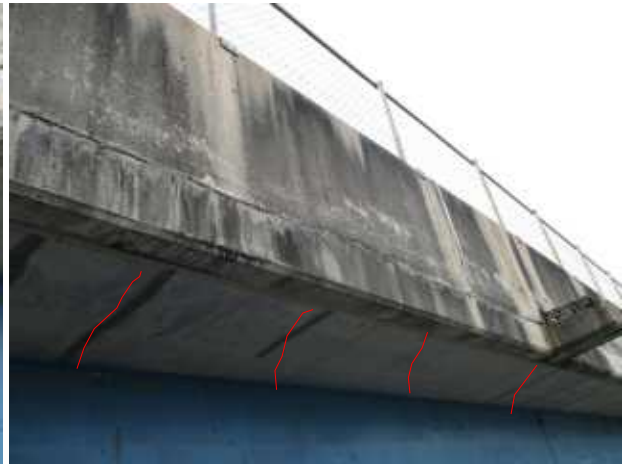
S3 바닥판 하면 균열(0.3mm미만)
